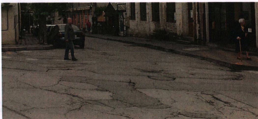
Снимка №3: Повреди по уличната настилка
